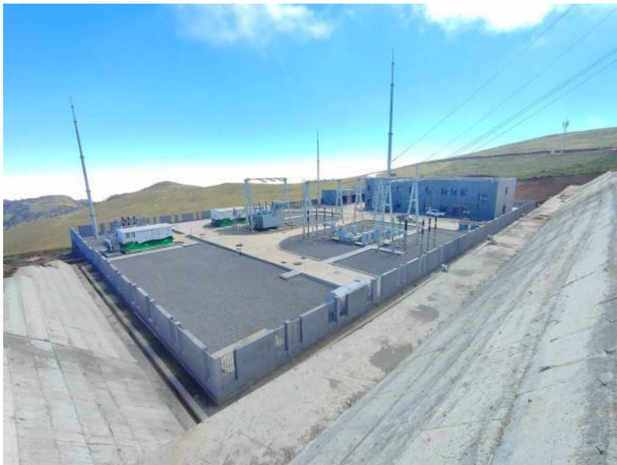
图 1-4 沙马乃拖 110kv 升压站
